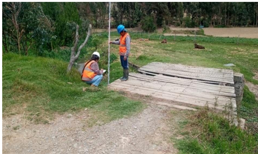
Fotografía 15: Puente construido con tablones de maderas en deterioro sobre el cauce del río Opamayo. La mayoría de puentes que se encuentran en este tramo son de este material (puentes rústicos).
