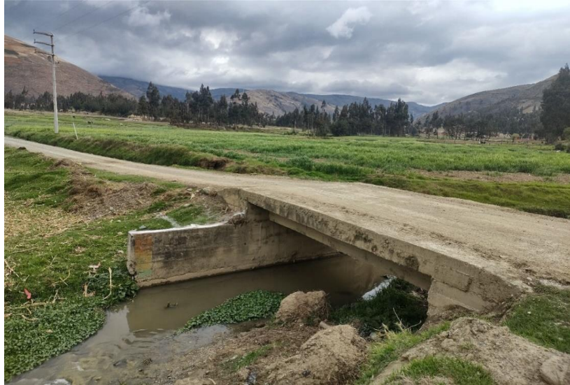
Fotografía 14: Puente de concreto ya deteriorado sobre el cauce del río Opamayo.
