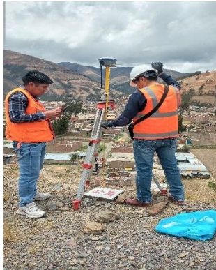
Instalación de los equipos topográficos y configuración del programa en la tablet con apoyo del topógrafo, garantizando su correcto funcionamiento y precisión.
