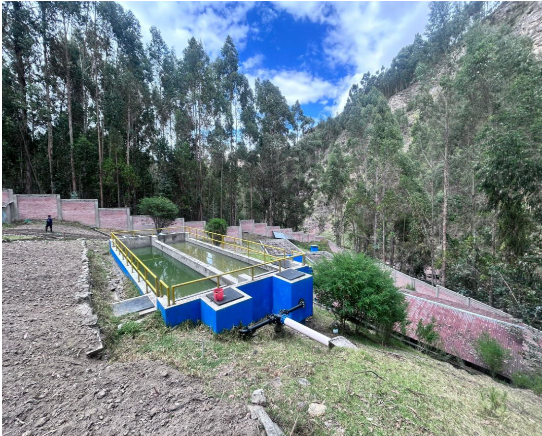
Figura 15. Planta de tratamiento de aguas residuales Yauli-Huancavelica
